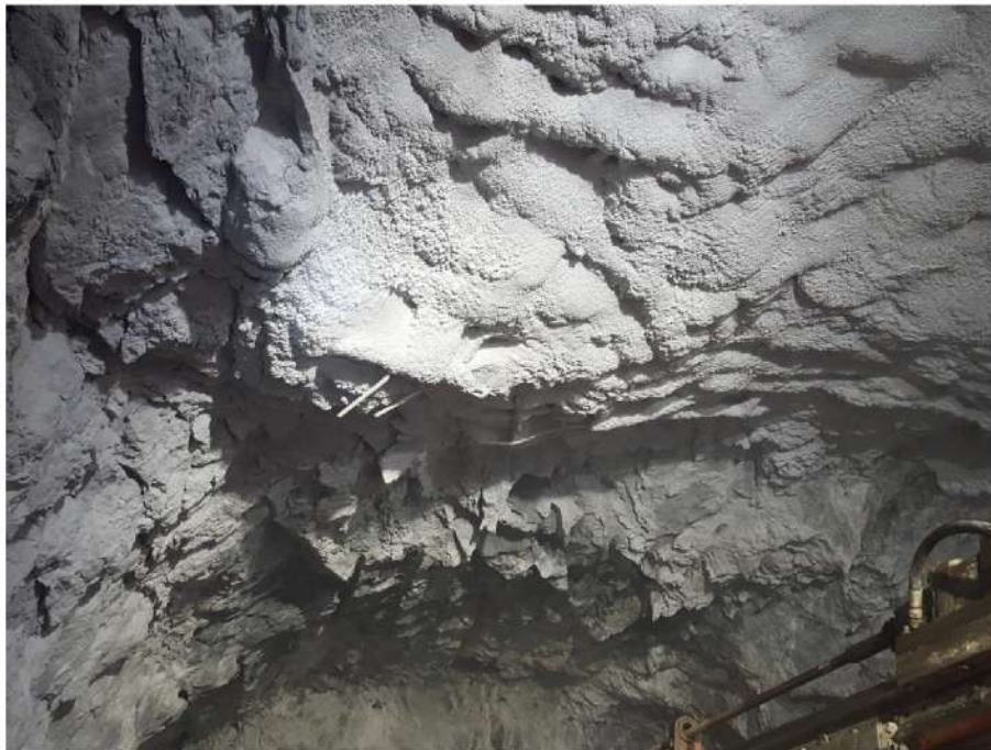
Рисунок 4.25. Участок кровли опытного участка ДШ-6 после производства взрывных работ незакрепленной части (слева) и закрепленной усиленной комбинированной крепью с торкрет-бетоном
