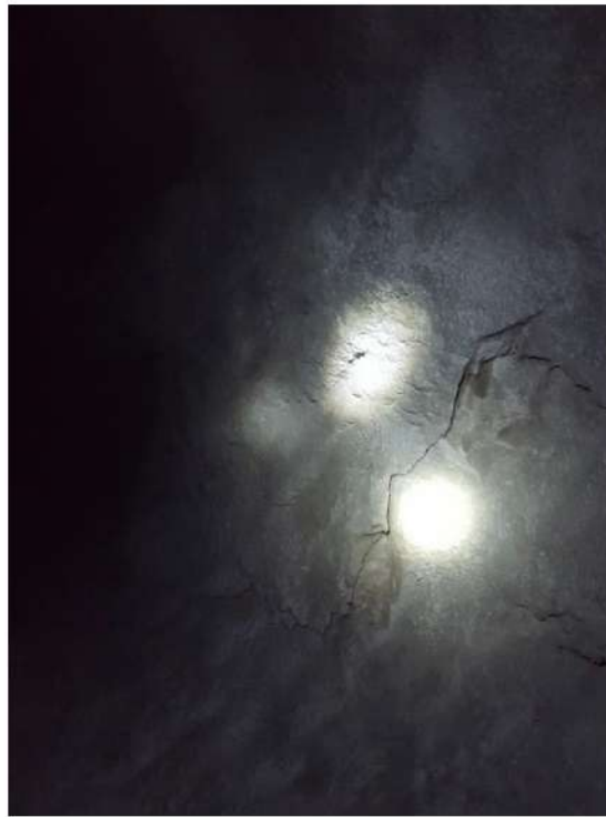
Рисунок 4.26. Участок правого борта ДШ-6 с механическим разрушением слоя торкрет-бетона
