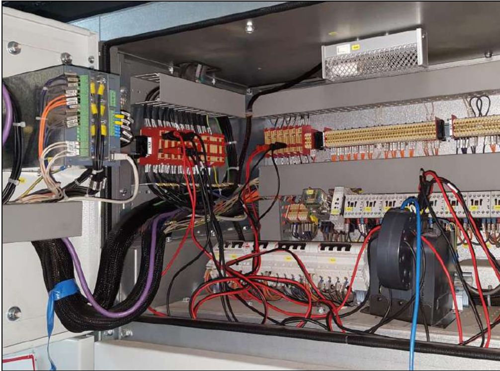
Рисунок 2.6 – Измерительный комплекс на базе анализатора качества электроэнергии ELSPEC G4420 для исследования гармонического состава напряжений токов в распределительной сети 10 кВ АО «Металлургический завод Балаково» (Россия)
