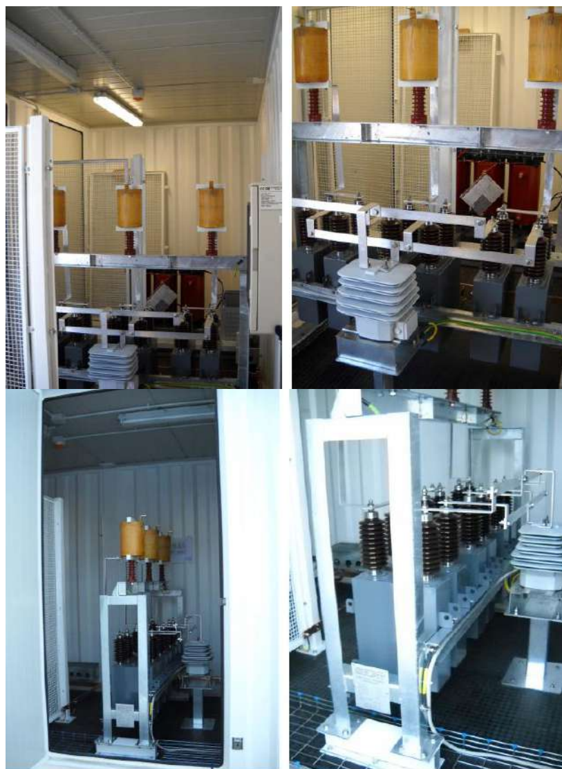
Рисунок 5.6 – Фотографии СПФ мощностью 2 \times 750 кВАр, L_p = 100 мкГн фирмы производителя ENERLUX POWER s.l.r, внедренного на предприятие с установкой в РП-5 «Газоочистка»
