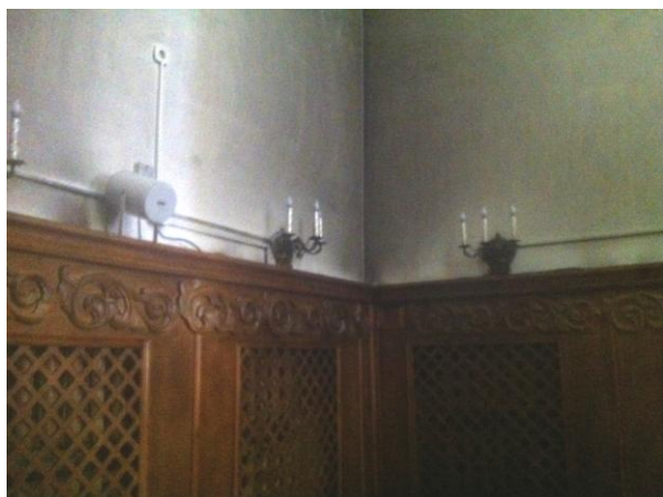
Рис. 2. Следы «закопчения» нижней части наружной стены храма
