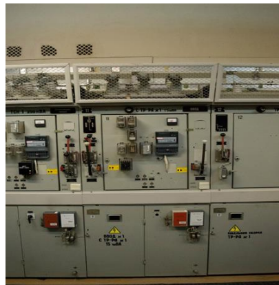
Рис 23 – Щит постоянного тока
