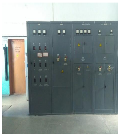
Рис. 8 – Шкаф управления обдувом трансформатора.
