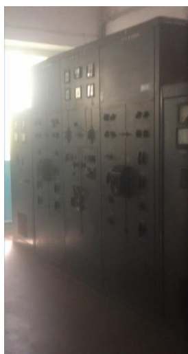
Рис 9 – Щит постоянного тока.
