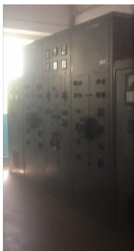
Рис 9 – Щит постоянного тока.
