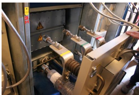
Рис №37 – вакуумный выключатель
