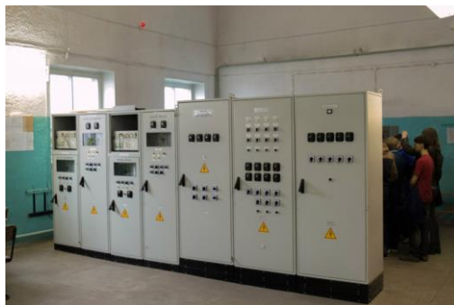
Рис 6 – Шкафы дистанционной защиты.
