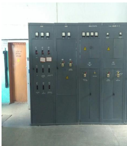
Рис. 8 – Шкаф управления обдувом трансформатора.
