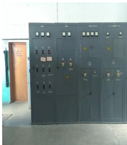
Рис. 8 – Шкаф управления обдувом трансформатора.
