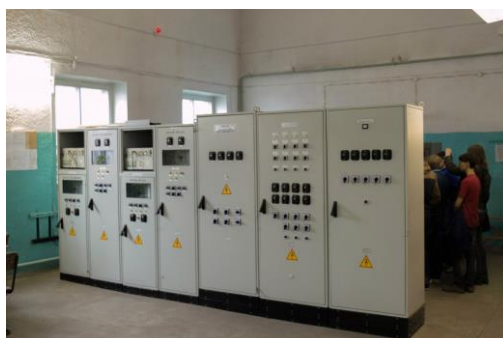
Рис 6 – Шкафы дистанционной защиты.
