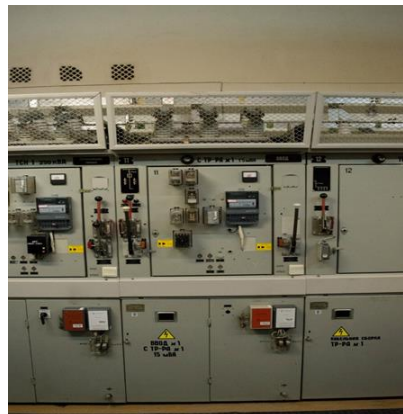
Рис 23 – Щит постоянного тока
