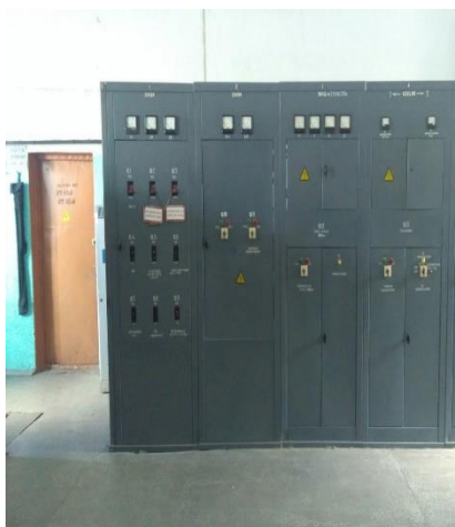
Рис. 8 – Шкаф управления обдувом трансформатора.
