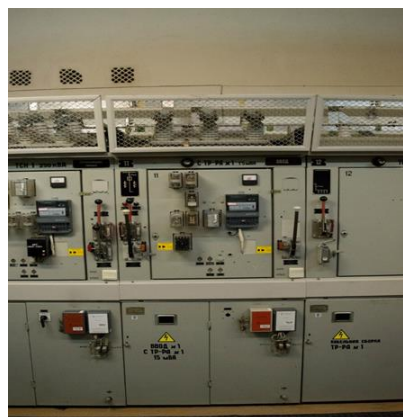
Рис 23 – Щит постоянного тока
