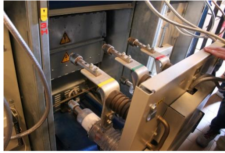
Рис №37 – вакуумный выключатель
