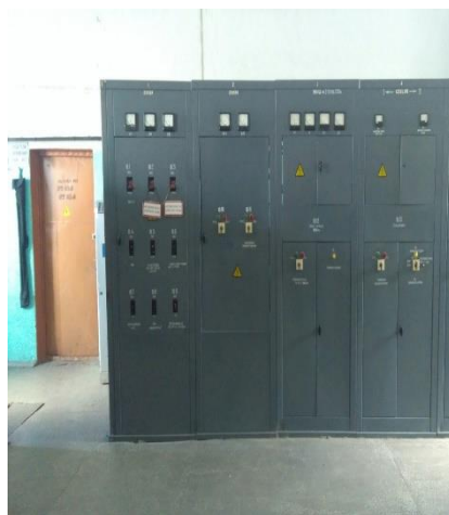
Рис. 8 – Шкаф управления обдувом трансформатора.
