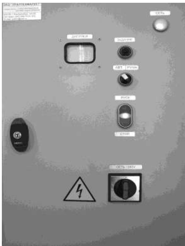
Рисунок 2 – Внешний вид шкафа управления стандом:
