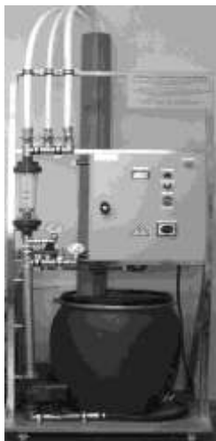
Рисунок 1 - Внешний вид стенда. 1-Центробежный насос; 2-Датчик давления; 3-Задвижка для регулирования дросселированием; 4-Монометр; 5-Монометр после задвижки; 6-Ротаметр; 7-Задвижки для имитации потребителя; 8-Шкаф с системой управления приводом насоса; 9-Сливная труба; 10-Ёмкость с водой.
