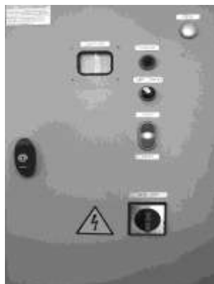
Рисунок 2 – Внешний вид шкафа управления стендом:
