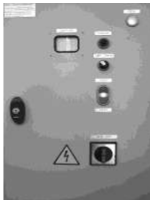
Рисунок 2 – Внешний вид шкафа управления стандом:
