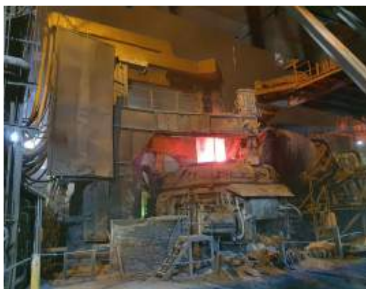
Рис. 1.8. Исследуемая модульная ДСП-1 (ГМП-1) 120 т. 95 МВА, функционирующая на одном из отечественных металлургических заводов
