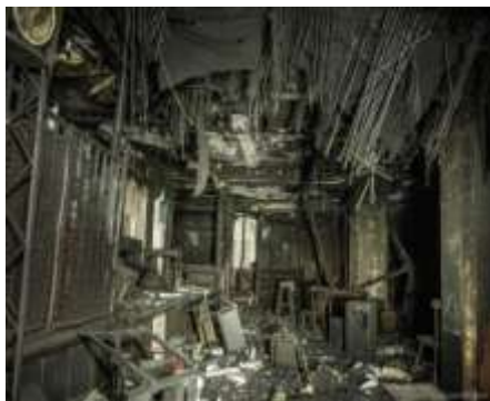
Рис. 1. Состояние конструкций клуба «Хромая лошадь» после пожара
