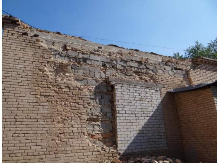
Рис. 3. Аварийное разрушение карниза и стены одноэтажного здания
