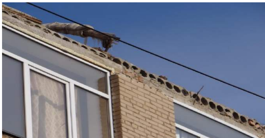
Рис. 1. Аварийное разрушение карниза четырехэтажного здания
