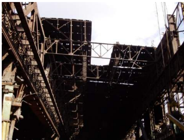
Рис. 4 – Общий вид пролета после обрушения
