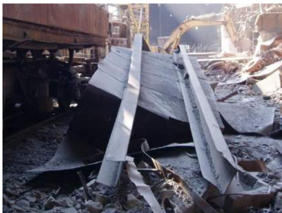
Рис. 5 – Участок рухнувшей кровли
