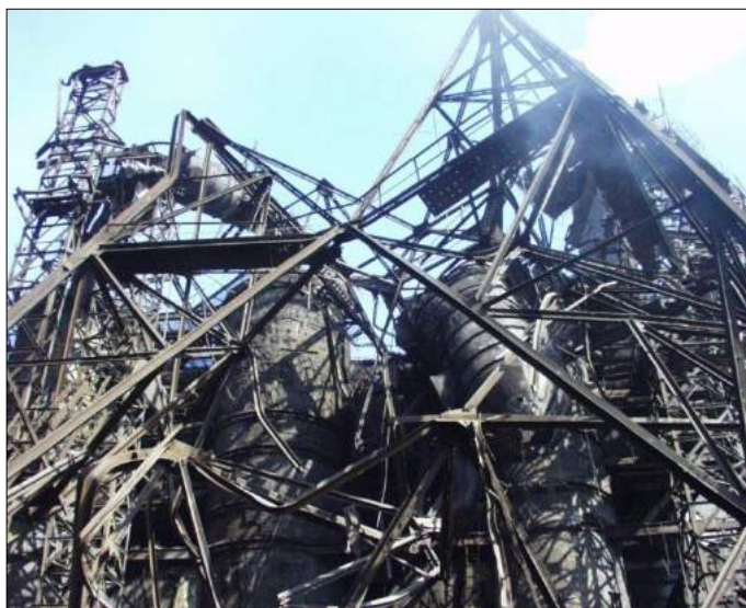
Фото 1. Аварийное обрушение вытяжной башни высотой 100 метров сероулавливающих установок Горно-обогажительного производства
