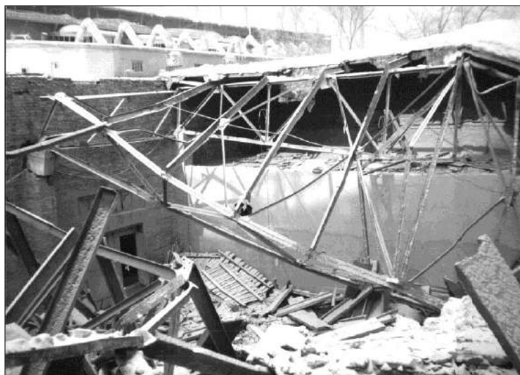
Фото 3. Обрушение покрытия цеха обжига
