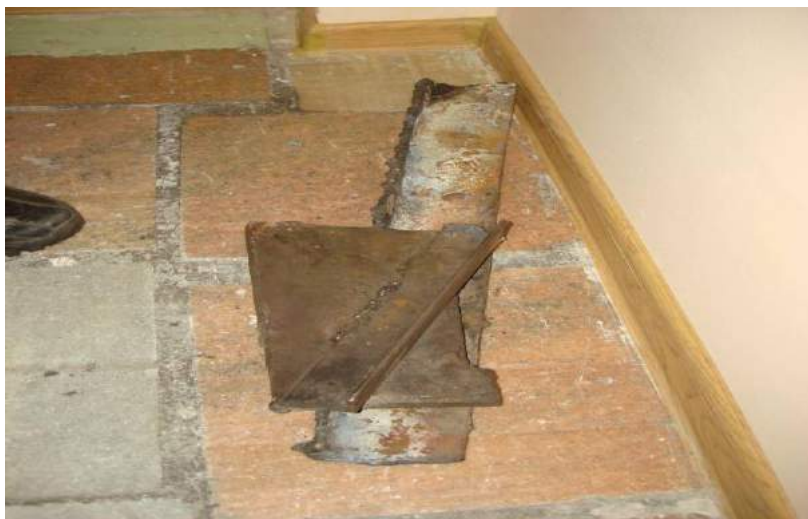
Рис. 2 – Общий вид фрагмента площадки обслуживания крановых колёс после обрушения
