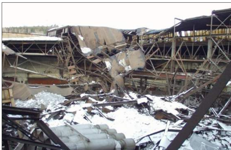
Фото 2. Обрушение покрытия здания адьюстажа термокалибровочного цеха
