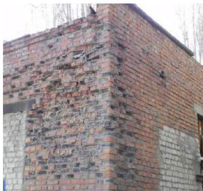
Рис. 5. Разрушение кирпичной кладки стены ЦТП
