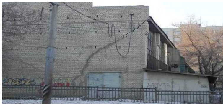
Рис. 4. Трещина по торцевой стене котельного отделения
