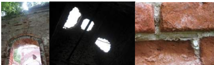
Рис. 2. Дефекты кирпичной кладки: 1 – трещина над арочным проемом; 2 – выпадение кирпичей в сомкнутом своде предалтарного объема; 3 – высолы на поверхности кирпичной кладки
