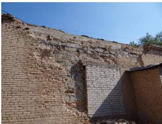
Рис. 2. Аварийное разрушение карниза и стены одноэтажного здания
