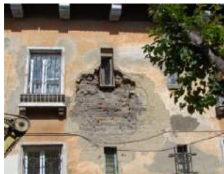
Рис. 1. Общий вид разрушения каменной кладки и штукатурного слоя
