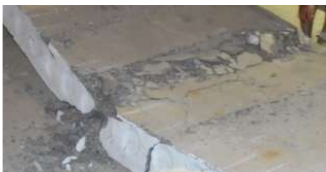
Рис. 4. Плита после разрушения со снятыми грузами
