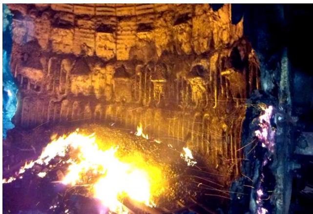
Рис. 1. Вышедшие из строя холодильники доменной печи
