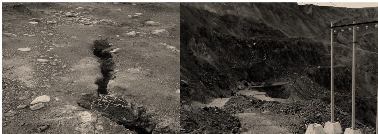
Рис. 1. Трещина в борту карьера Камаган
