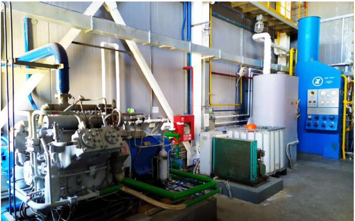
Рисунок 4.10 – Установка разделения воздуха «АжКж 0,06» №1 в составе азото-кислородной станции
