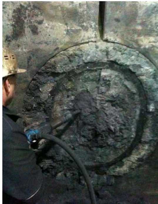
Рисунок 6.11 – Подготовка к отбору пробы материала из лёточного канала внутри доменной печи №4 во время капитального ремонта
