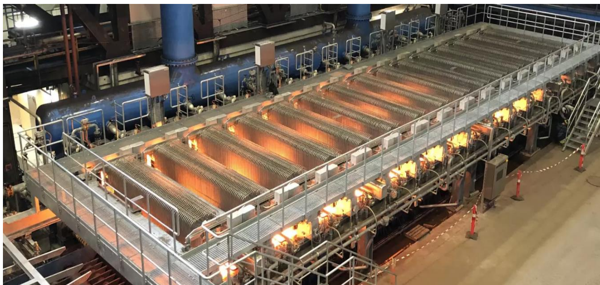
Рисунок 1.3 – Современная установка ламинарного УО с U-образными трубками производства SMS-Group [28]
