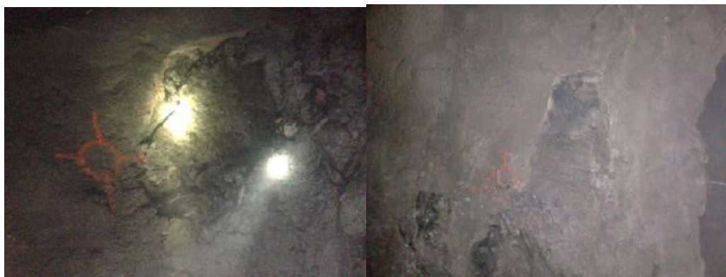
Рисунок 5.17. Участок отслоения торкретбетонной крепи
