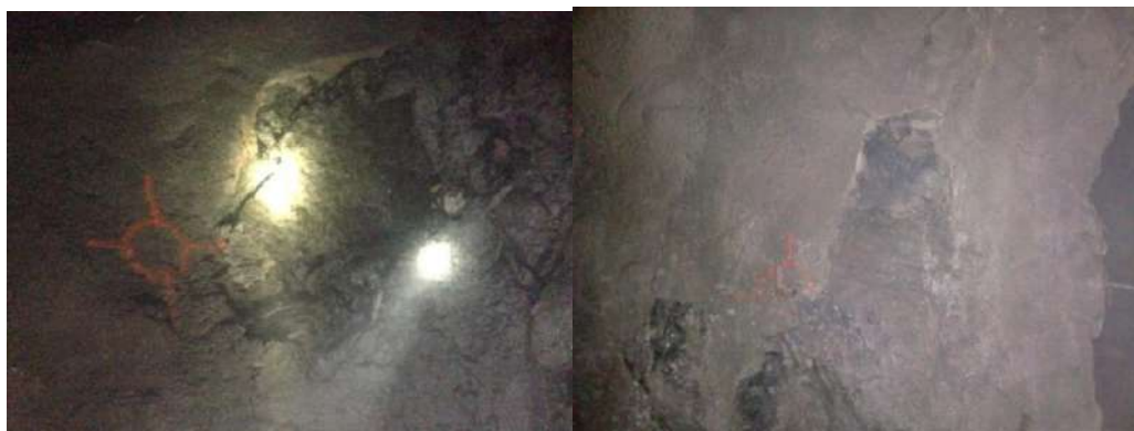
Рисунок 5.17. Участок отслоения торкретбетонной крепи
