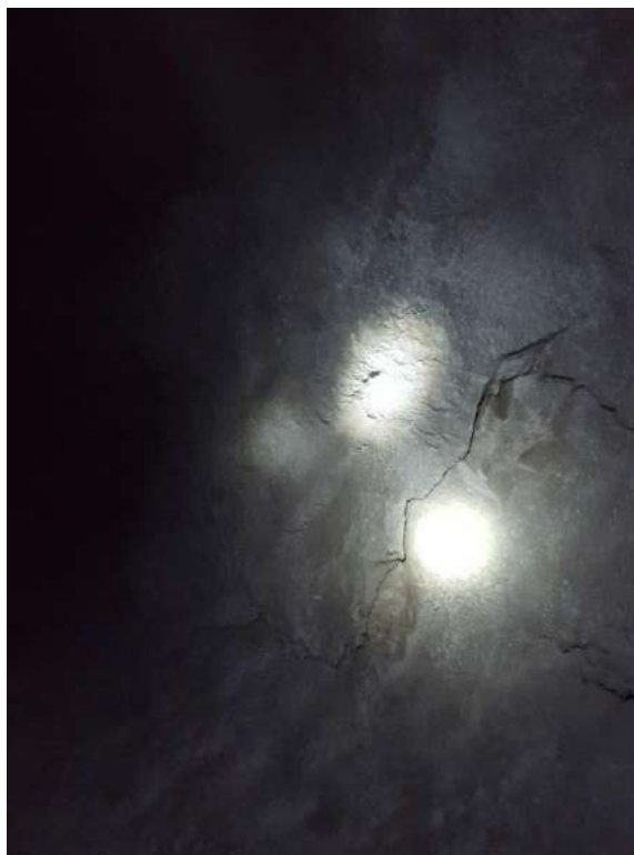
Рисунок 5.6. Участок правого борта ДШ-6 с механическим разрушением слоя набрызгбетона
